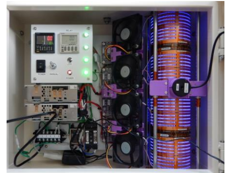
100L/分 流水殺菌装置 (排水処理施設の設置例)
